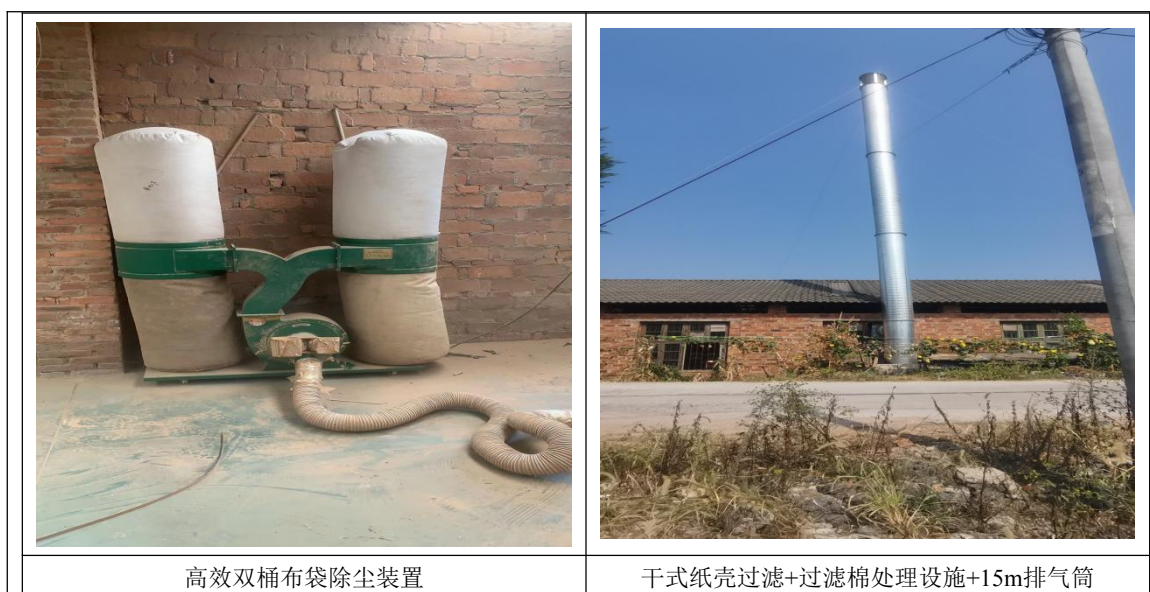
图 3-3 废气处理设施
